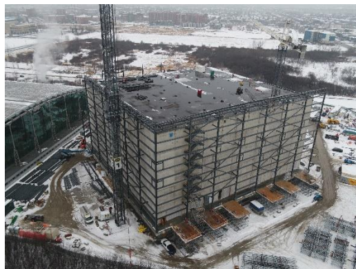
Le futur Édifice d'entreposage et de préservation de BAC en construction, en 2020.
